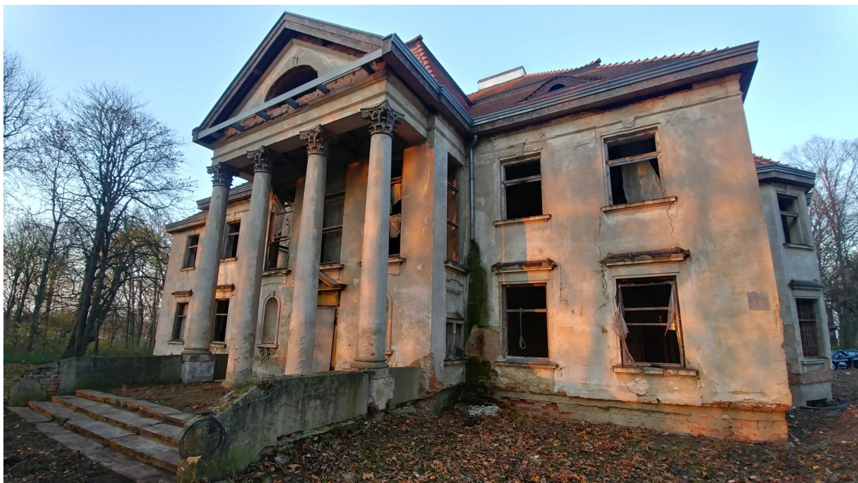
Stan pałacu około 2018 r. – elewacja frontowa przed obecnym etapem ratowania zabytku.
