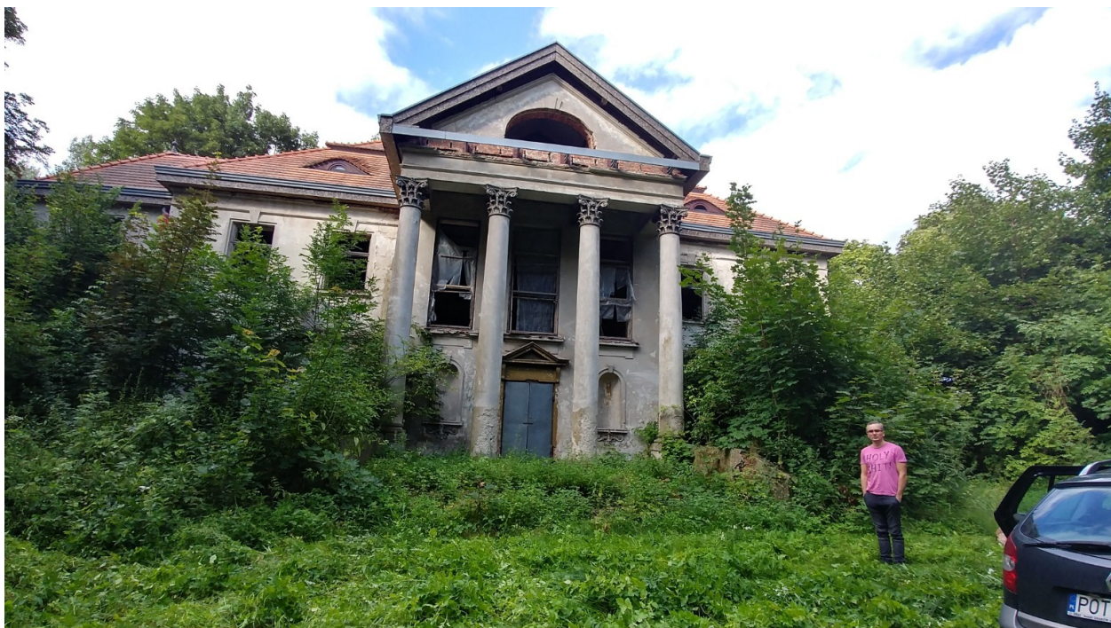
Stan sprzed obecnego remontu – zarośnięty podjazd i silna degradacja elewacji.
